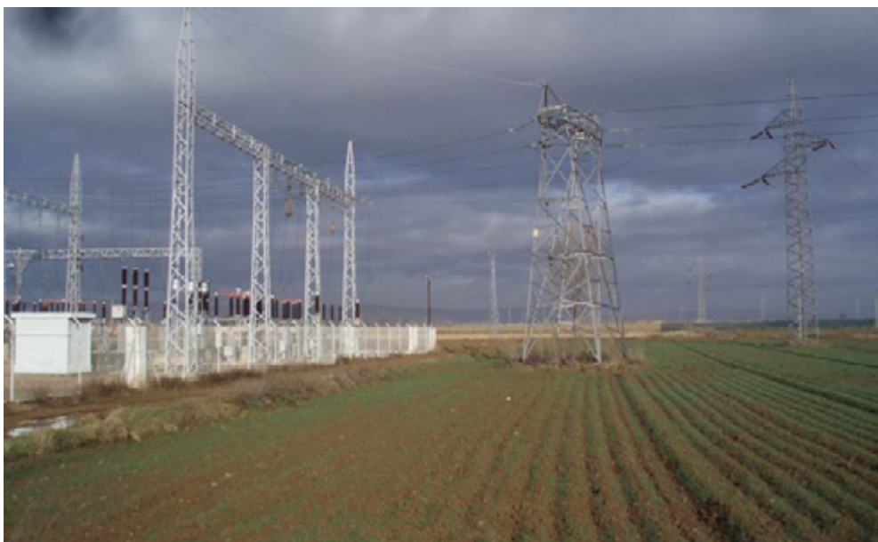
Subestación Hospital de Órbigo
