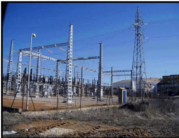
Subestación de Cifuentes
