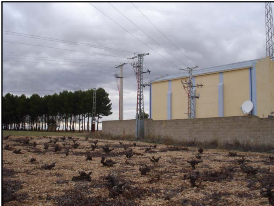
Foto N° 1: Subestación de Socuéllamos
