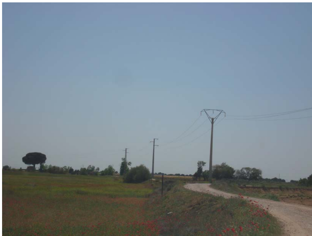
Foto N° 11: Llegada Apoyo 5 de la derivación a Pedro Muñoz de la LAT Alcázar I-Socuéllamos
