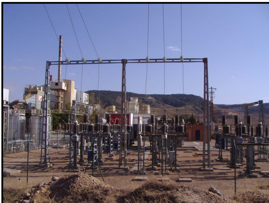
FOTO 20: SUBESTACIÓN DE LOS HUEROS
