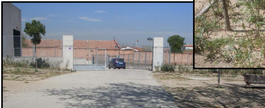
Vista entrada principal a la subestación.
