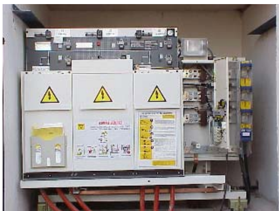
CELDA BLINDADAS DE ENTRADA / SALIDA DE LINEA Y PROTECCION DE TRAF0
