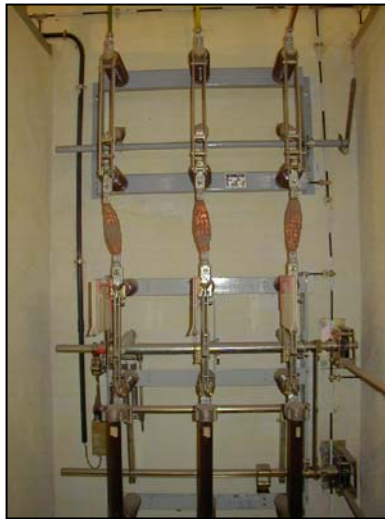
CELDA CONVENCIONAL DE PROTECCION DE TRAF0
