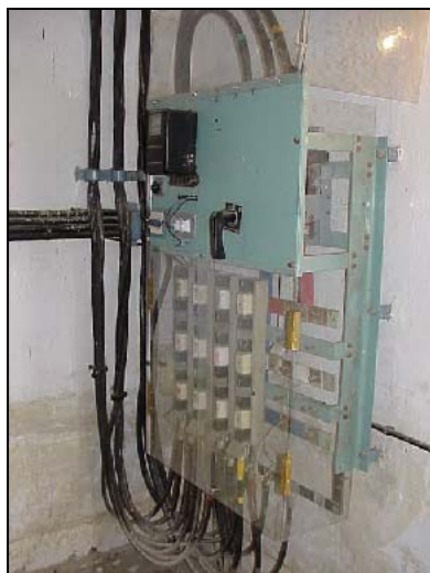
CUADRO CON INTERRUPTOR BT Y BASES PORTAFUSIBLES ABIERTAS
