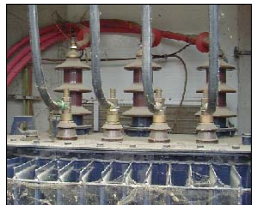
CONEXIONES TRAF0: PASATAPA S DE MT/BT CON CONEXIONES ROSCADAS DESNUDAS
