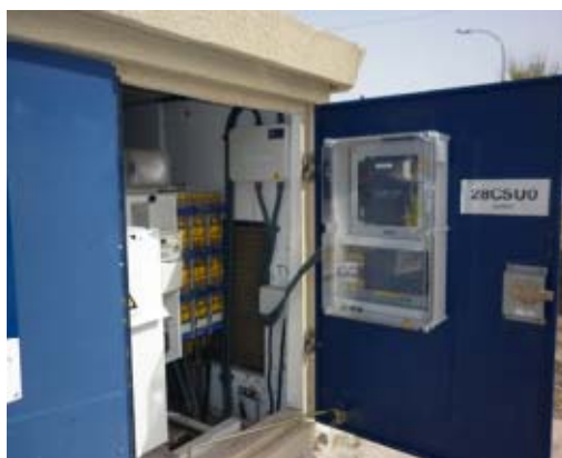
CUADRO GCT EN CT PREFABRICADO
