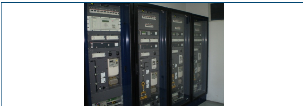
Armarios de Protecciones y Cuadro de control
