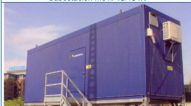
Vista exterior de carretón 45 kV
