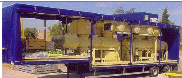
Carretón 132-66 kV en emplazamiento para ser utilizado
