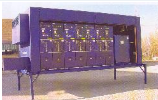
Disposición de carretón 20-15 kV para ser utilizado
